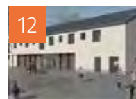
12 VIE À L'ÉCOLE Soucieu-en-Jarrest dans l'Ouest lyonnais Une nouvelle école catholique en construction
